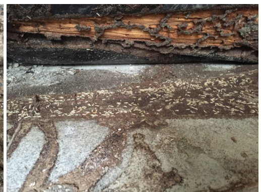
©SENTRI TECH - Galeries empruntées par des termites
