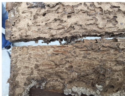
©SENTRI TECH - Dégâts termites
