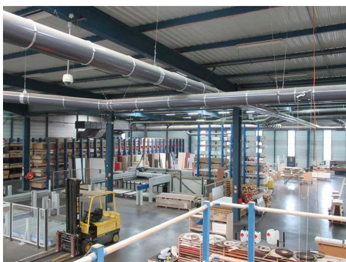
©France Rangement, Atelier de fabrication
