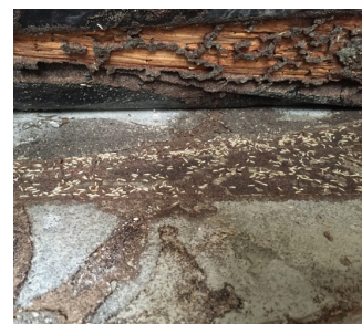
Galerie de termites
