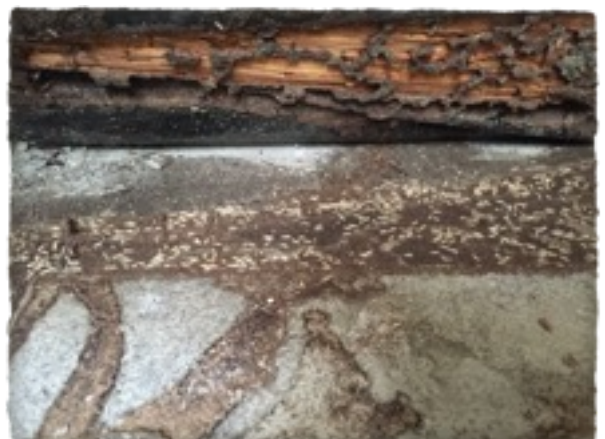
©SENTRI TECH - Autoroute dégât termites
