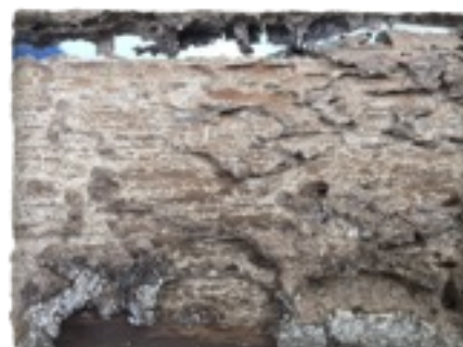
©SENTRI TECH - Dégât termites
