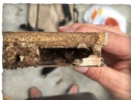
©SENTRI TECH - Dégât termites
