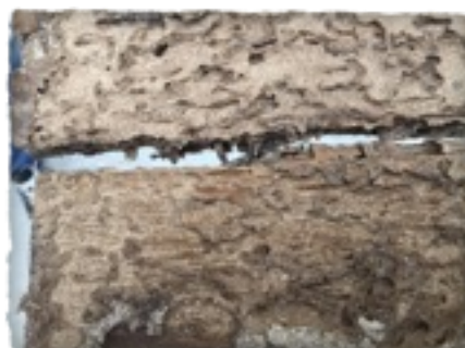
©SENTRI TECH - Dégât termites
