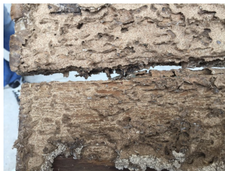
©SENTRI TECH - Dégâts termites
