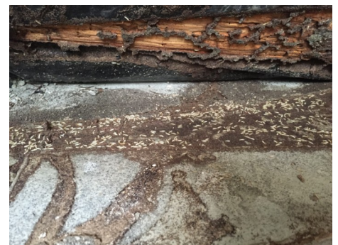
©SENTRI TECH - Galeries empruntées par des termites
