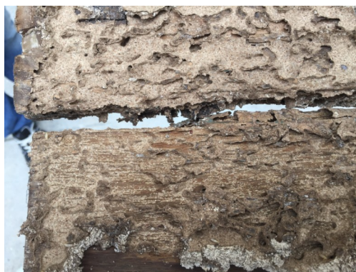
©SENTRI TECH - Dégâts termites
