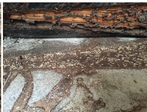
©SENTRI TECH - Galeries empruntées par des termites
