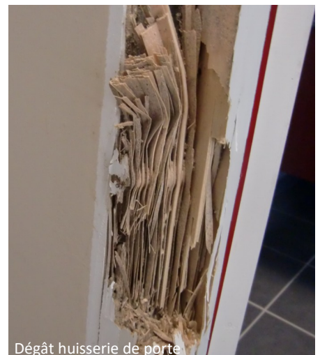
Dégât huisserie de porte
