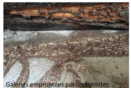
Galeries empruntées par les termites
